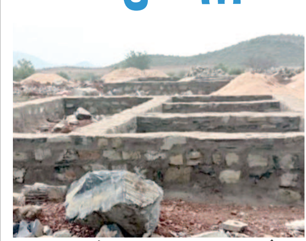
అన్నమయ్య ప్రాజెక్టు వరదబాధిత గ్రామం పులపత్తూరులో నిలిచిపోయిన పక్కా ఇళ్ల నిర్మాణం
